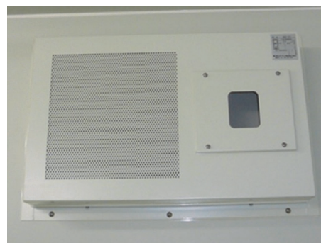
写真 2. HEPA 付き差圧ダンパー
